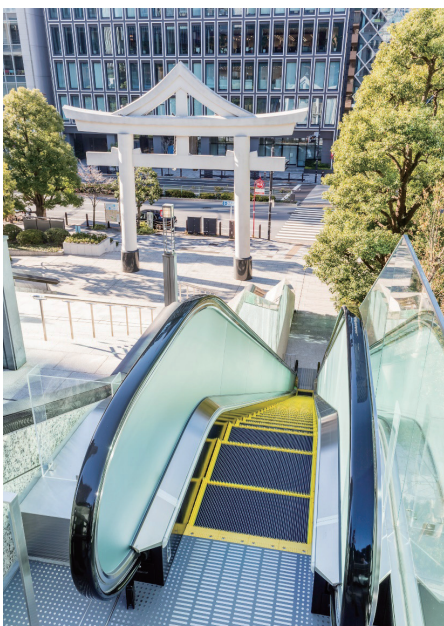
3号機 エスカレーター(勾配30度)
