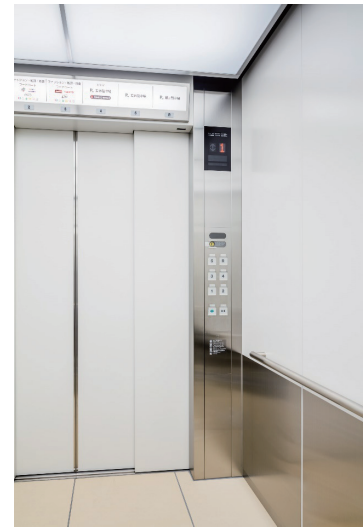
客用エレベーター 操作盤
