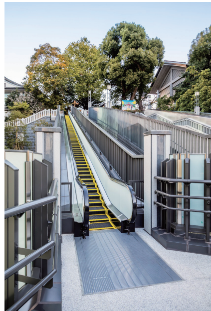
2号機 エスカレーター(勾配16度)
