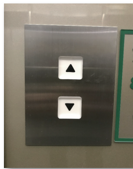
改修後 乗場ボタン 全面点灯式で視認性、操作性の優れたボタンへ改修
