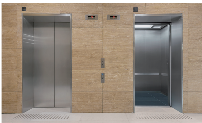
CB-PL-03/1、2号機 8階エントランス
