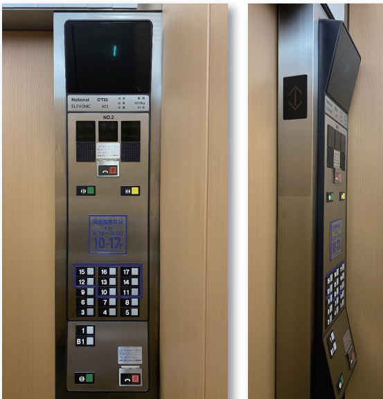
改修前 かご内操作盤
