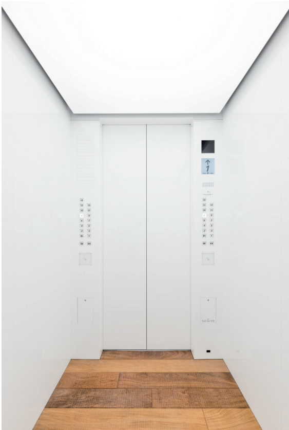
EV5号機 かご内
