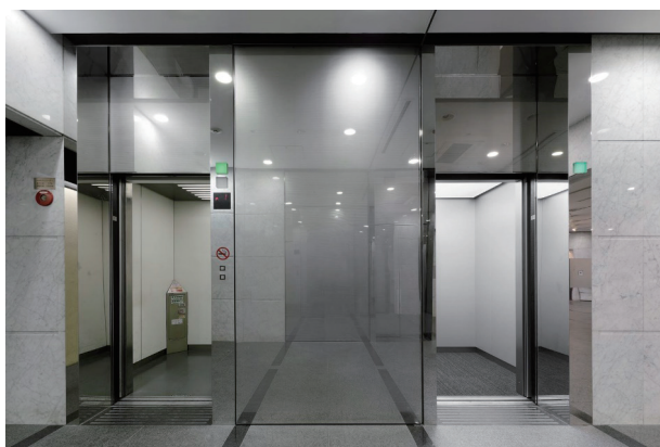
1階乗場戸開時 (左側号機：リニューアル前) (右側号機：リニューアル後) 【乗場用品既設流用】
